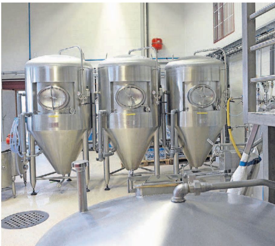
Die neue Brauanlage, im Bild drei der vier Tanks, in Ziefen.
